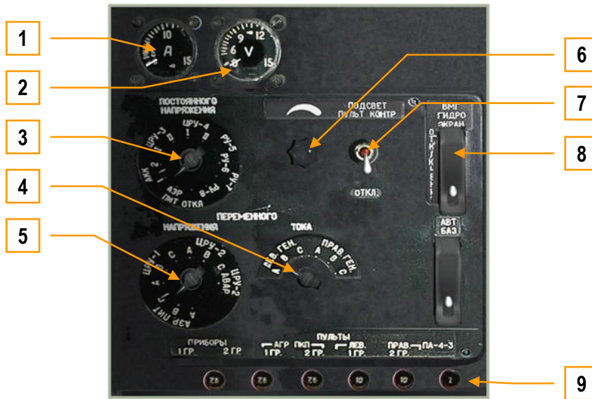
6-71 : Panneau de contrôle du système électrique
