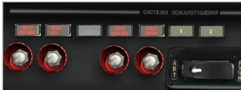
10-19 : Poste de contrôle du système d'extinction
